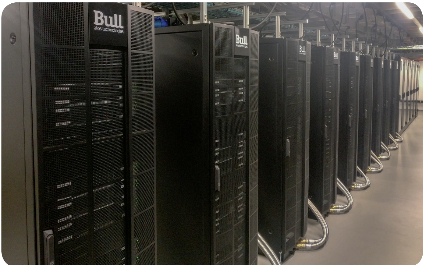
2_HLRN-IV, Phase 1, am Standort Göttingen: 448 Rechenknoten mit insgesamt 17.920 Prozessorkernen
