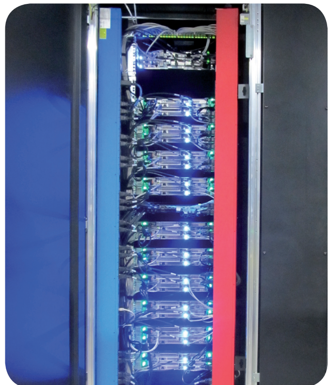
2_Rückansicht eines der Racks mit geöffneter Rückwand
